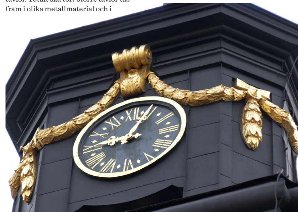
Björn Hammar har nyligen restaurerat ornamentet på klocktornet på Svartsjö slott på Färingsö. Orginalet är från 1700-talet och materialet i det nya ornamentet är tillverkat av titanzink från Rheinzink.
